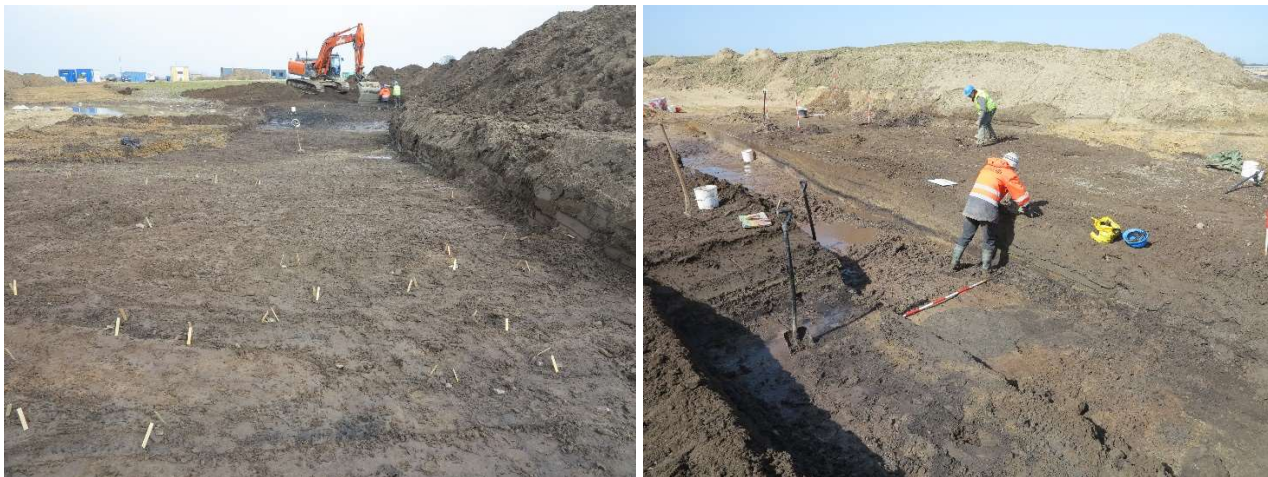
Figur 53: Til venstre ses det nyligt afrømmede A7091 i del 5, hvor man tydeligt ser entreprenørens arbejde i det omljerede område til venstre i billedet, og den stak jord der stadig mangler at blive fjernet til højre i billedet. Lige før maskinen ses det sorte lag 6. Set fra V. Billedet til højre er et arbejdsfoto af profilafrensningen af snit 3, og i front ses en cirkulær grube (A10455), som fremkom under opfyldningslagene. Set fra S.
